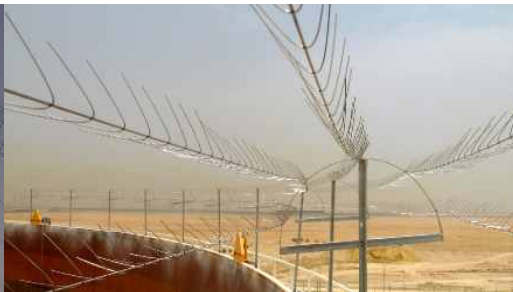
가장자리 어레이(Rim Array) Float Roof형의 유류 또는 가연성 물질 저장 탱크에 적용.
